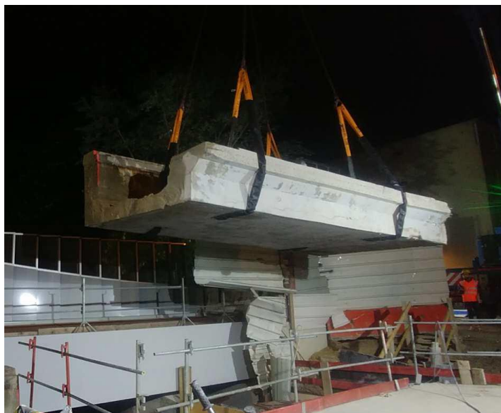
Figure 4 : Exemple d'évacuation par grutage avec passage des élingues dans le tablier - Source GINGER CEBTP
