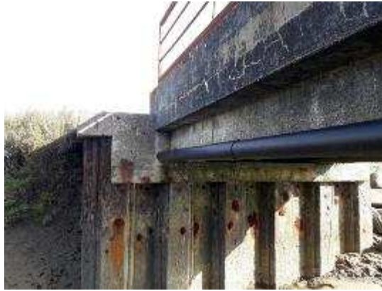
Photographie du réseau PEHD
