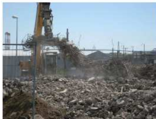
Exemple de déconstruction d'éléments en béton armé et séparation des aciers lors d'une opération de déconstruction
